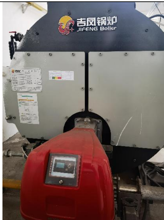
锅炉与低氮燃烧器
