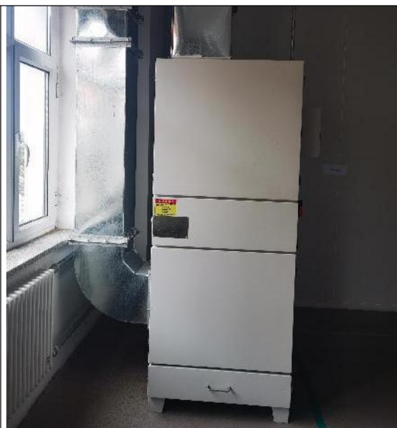
洗润切车间滤筒除尘器
