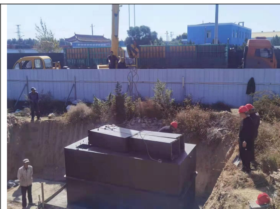
一体化污水处理设施
