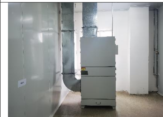
筛药间滤筒除尘器
